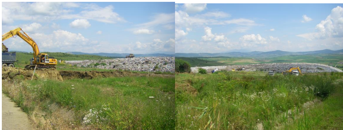
Figura 2-26 Depozitul conform de deșeuri din cadrul CMID Târgu
